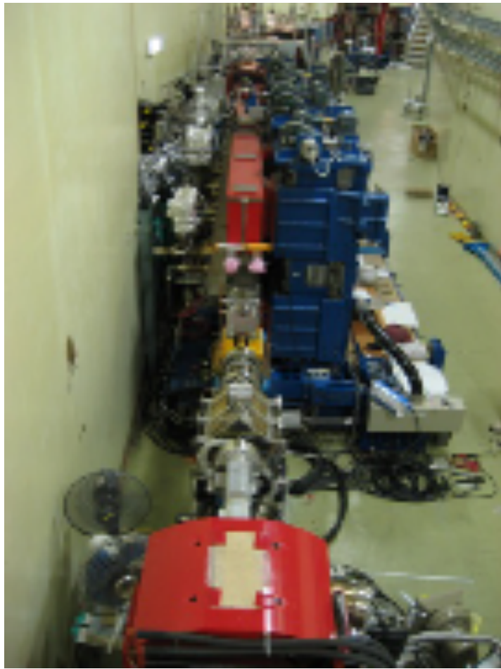
図 67 : パルス 6 極電磁石の設置。
