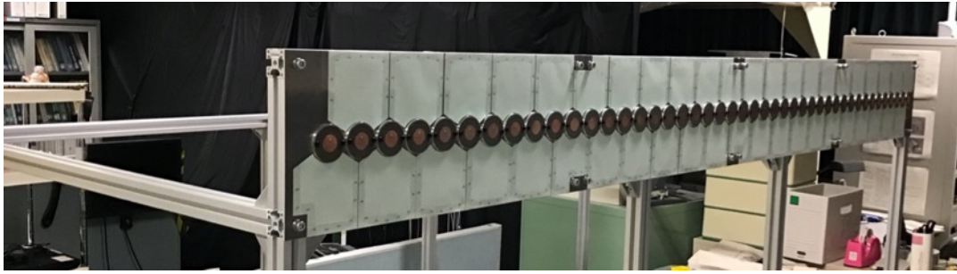
図 4-9 実際のアレーアンテナ架台
